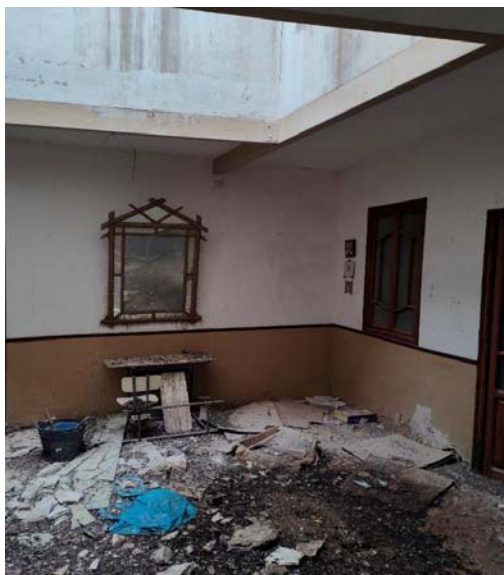
Derrumbe parcial de la claraboya que cubre el patio de luces central
