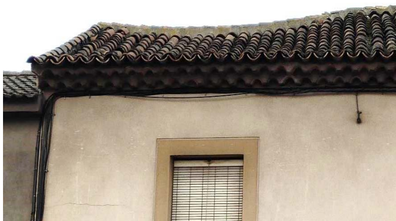
Cubierta deformada por mal estado de la estructura
