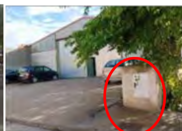
Armario de conexión eléctrica
