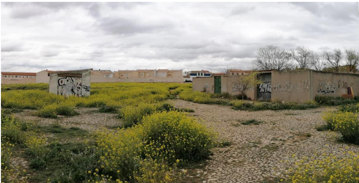
Cercados y edificación en mal estado en la central/norte del ámbito Eras de La Agustina.
